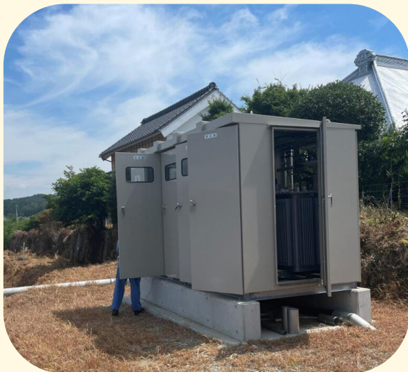
SIMを利用している発電設備
